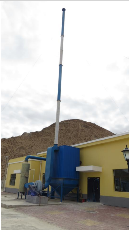
锅炉烟气脱硫除尘装置照片
